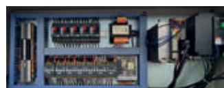
Quadro elettrico con componentistica Schneider
