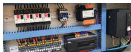
Quadro elettrico con componentistica Schneider
