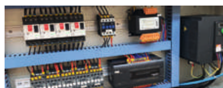
Quadro elettrico con componentistica Schneider
